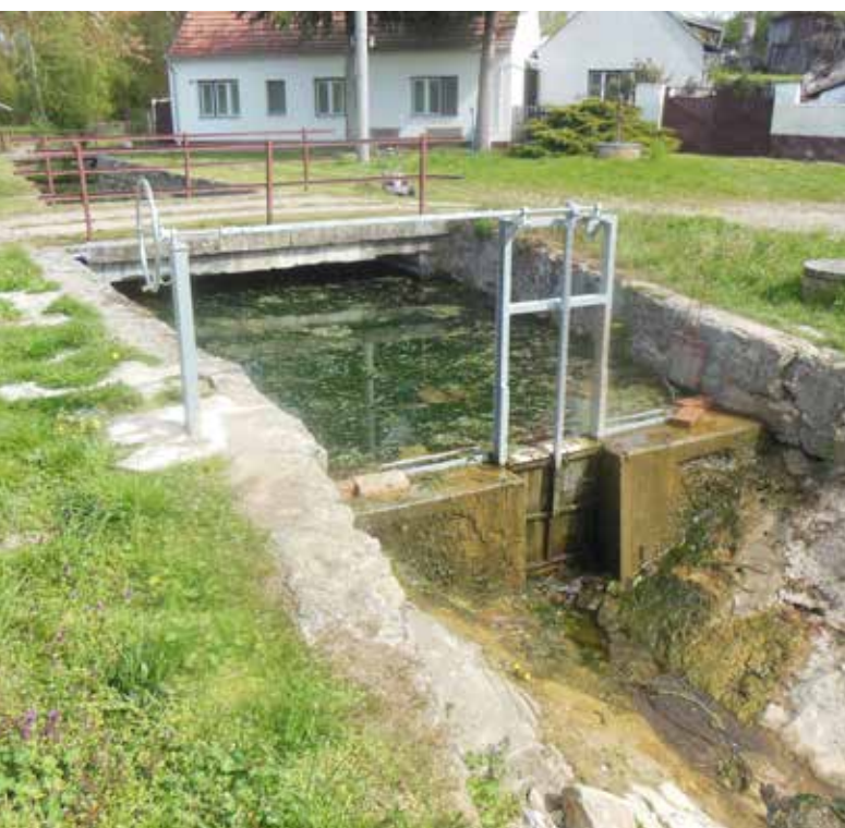
↓ Stávající stav narušeného opevnění
