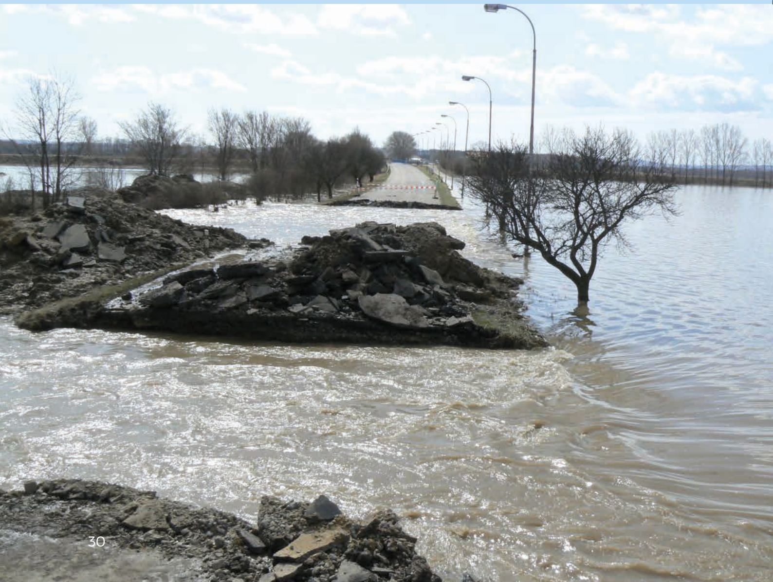
Detail prokopané silnice Hevlín-Laa při jarní povodni v roce 2006 ↓
