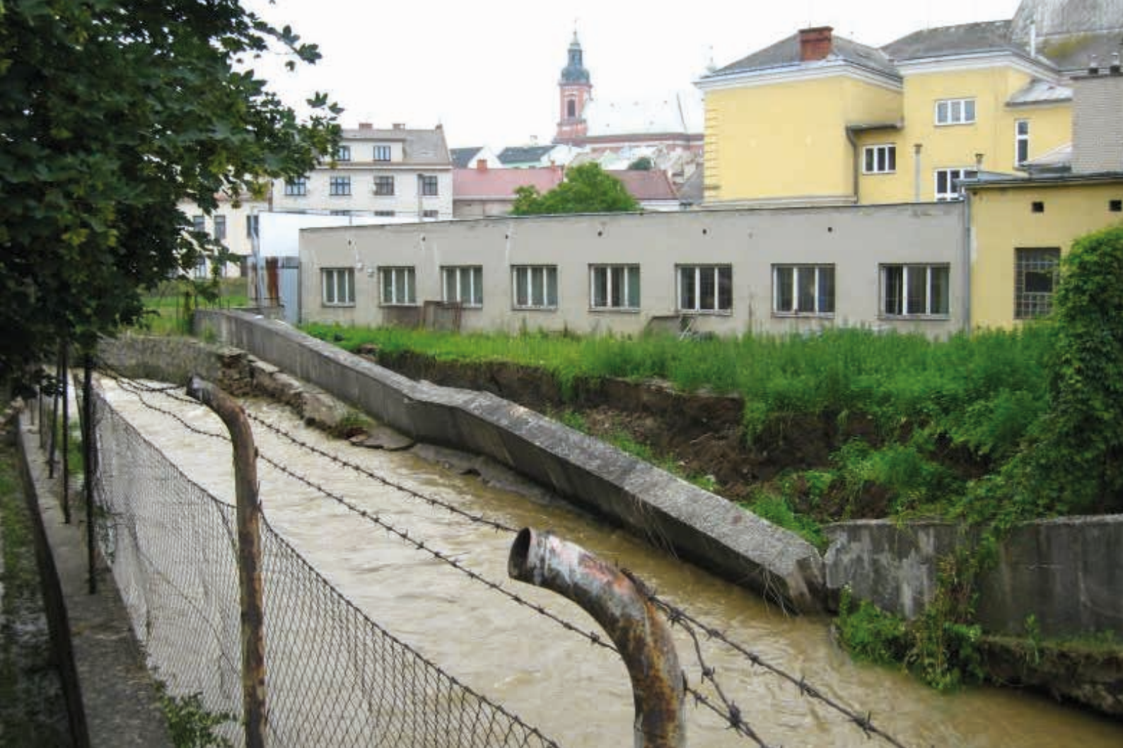
Poškozená zídka na Veličce v Hranicích – červen 2009 ↑
