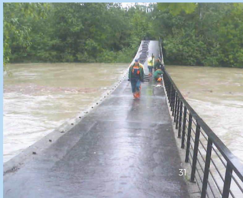
Demontáž zábradlí na mostní konstrukci cca hodinu před jejím přelitím – Přerov, lávka u tenisu ↓
